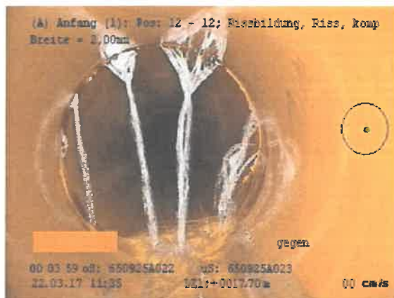
Abbildung 2: Schaden in einer Abwasserleitung
